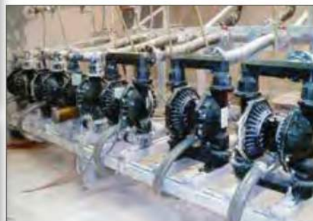
3" (76,2 mm) Membranpumpe eingesetzt zur Förderung von Schlicker in einer Keramikproduktion.
