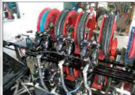
1" (25,4 mm) UL zertifizierte Kraftstoffpumpen installiert zur Kerosinbefüllung.
